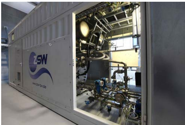
Blick in das Innere der Anlage.
