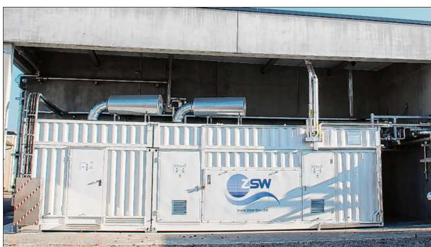
Der Forschungscontainer des ZSW ist direkt an die „Power-to-Gas“-Anlage angegliedert. Foto: Rolf Rombach
