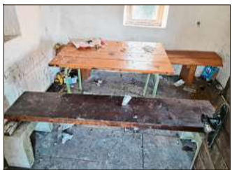
Zurückgelassener Müll und Sachbeschädigungen im Rebhaus Foto: zVg
